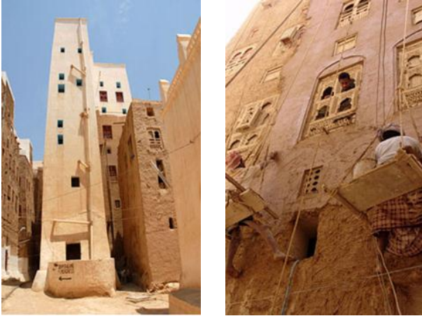
شكل رقم (3-27): أحد مباني شيبام أثناء وبعد عملية الترميم والتأهيل المصدر: Aga Khan Award Cycle, 2007
