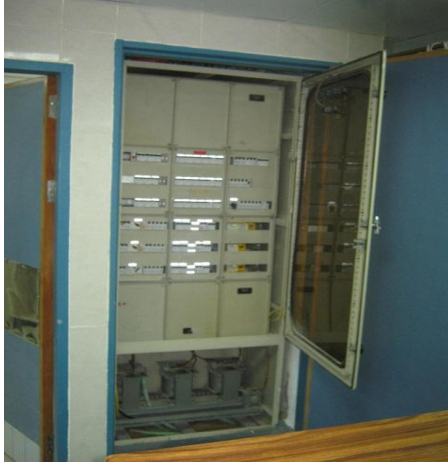
شكل رقم (٤-٣٣) صورة توضح لوحة الكهرباء الرئيسية لقسم العناية المركزة بالمستشفى المصدر الباحثة
