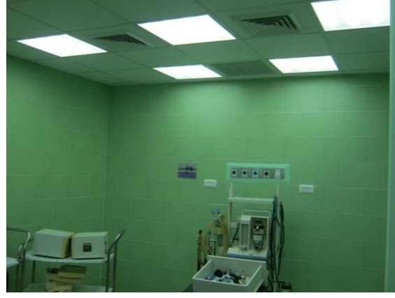
شكل رقم (٨-٤) صورة داخل أحد غرف العمليات المصدر: الباحثة
