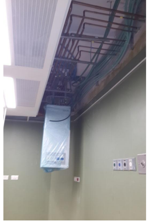
شكل رقم (٣-٦٦) صورة توضح شبكة الغازات الطبية داخل أحد غرف العمليات ( مستشفى الجراحات التخصصية) المصدر: الباحثة
