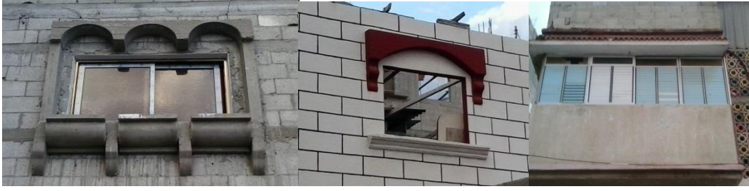
شكل(30.2) نماذج من وسائل التظليل المستخدمة في المباني السكنية في قطاع غزة
