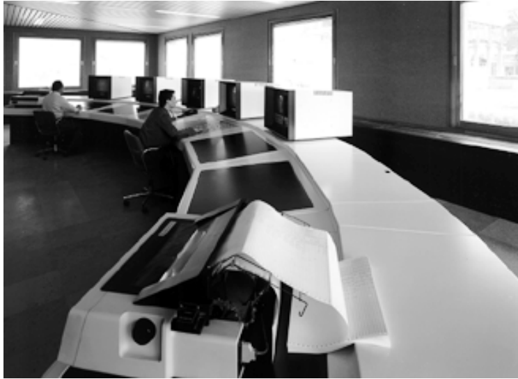
شكل ي ٢-١١ وحدات UPS متكاملة وجهاز داخل نظام إدارة مركزي .
