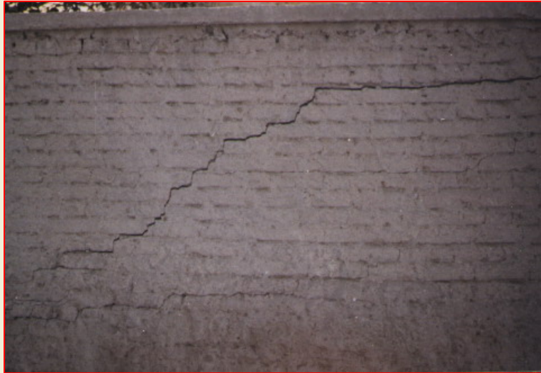
شروخ نتيجة الهبوط
