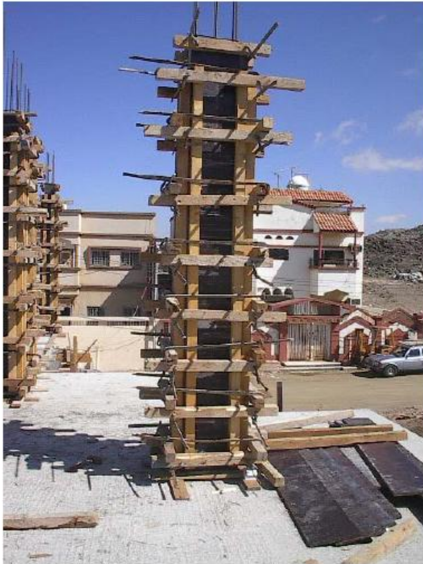
شكل رقم (٥٢) يبين تحزيم العمود باستخدام مرايبع وقصاير المرايبع الفلييري مع ضفدعة العمود باستخدام القمط الحديدية بدلا من ألواح الموسكي (تثبيت العمود رأسيا تأتي بعد الانتهاء من التقوية)
