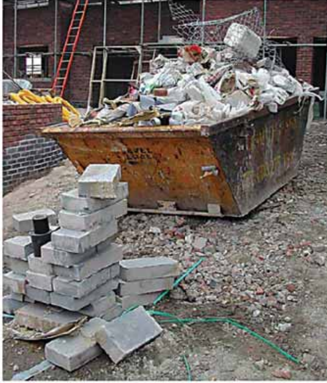
(الشكل 4.18) نفايات موقع البناء.
