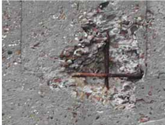
(الشكل 16.3) تآكل التسليح الفولاذي.
