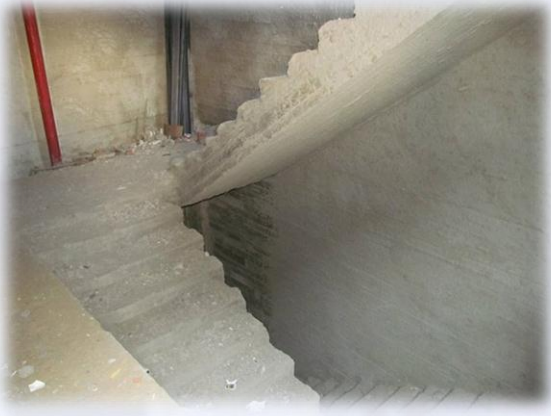
عدم وجود فانوس فى السلالم عمل على تقليل فرص تصوية المبنى
